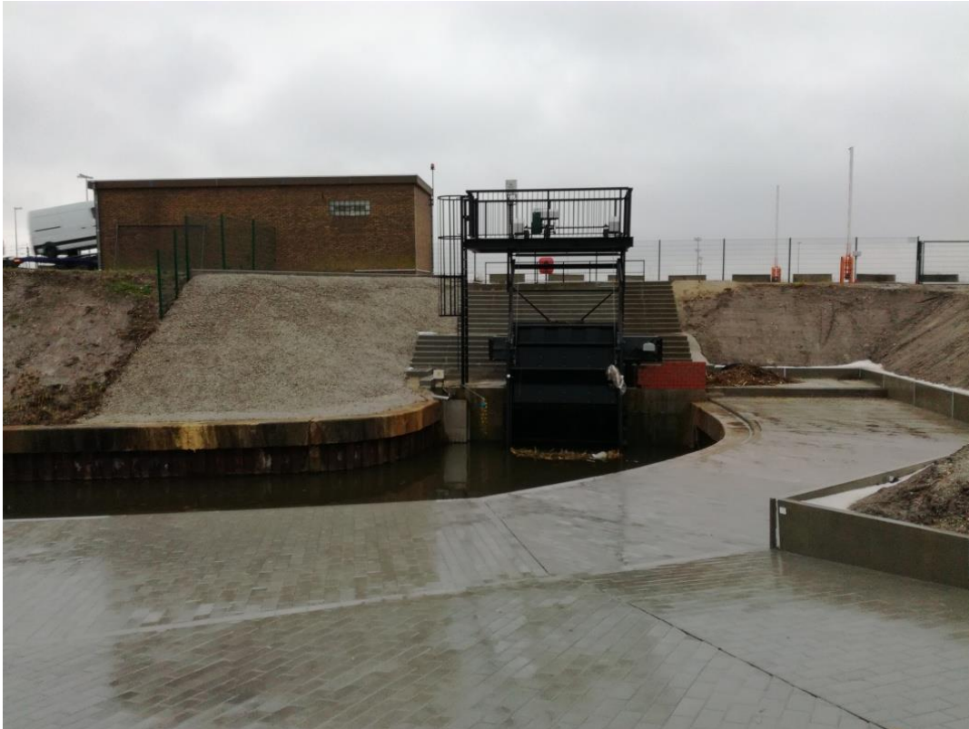
pompgebouw Isabellavaart in Zeebrugge
