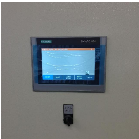
nieuw bedieningsscherm pomp Ronselare
